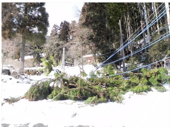
図A6－1倒木により配電線が断線した状況
