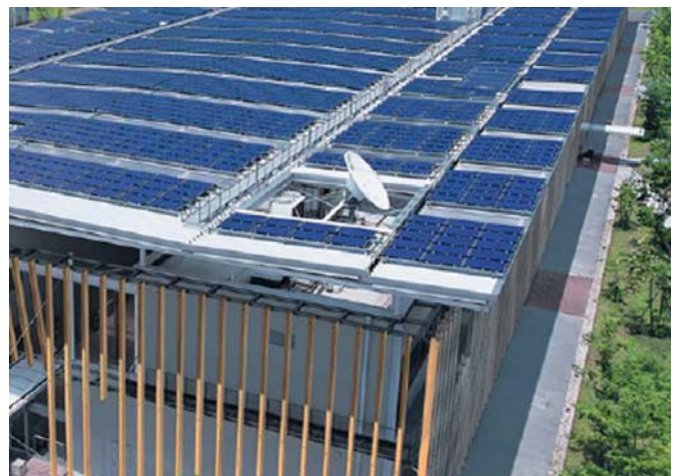
図1 太陽光発電システムの特徴(1/2) 屋上設置の太陽光発電システムと 衛星通信地球局アンテナの例
