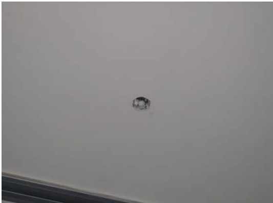
Fig-12 天井のスプリンクラーのカバーが抜け落ちた
