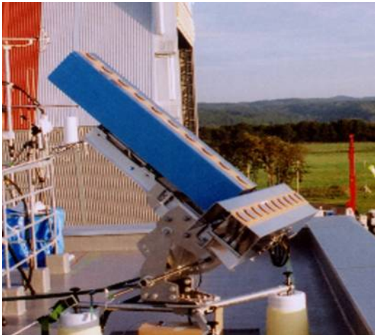
管制棟屋上に設置されたアレーセンサー。1軸あたり、パッチアンテナ10素子で到来方向が推定される。
